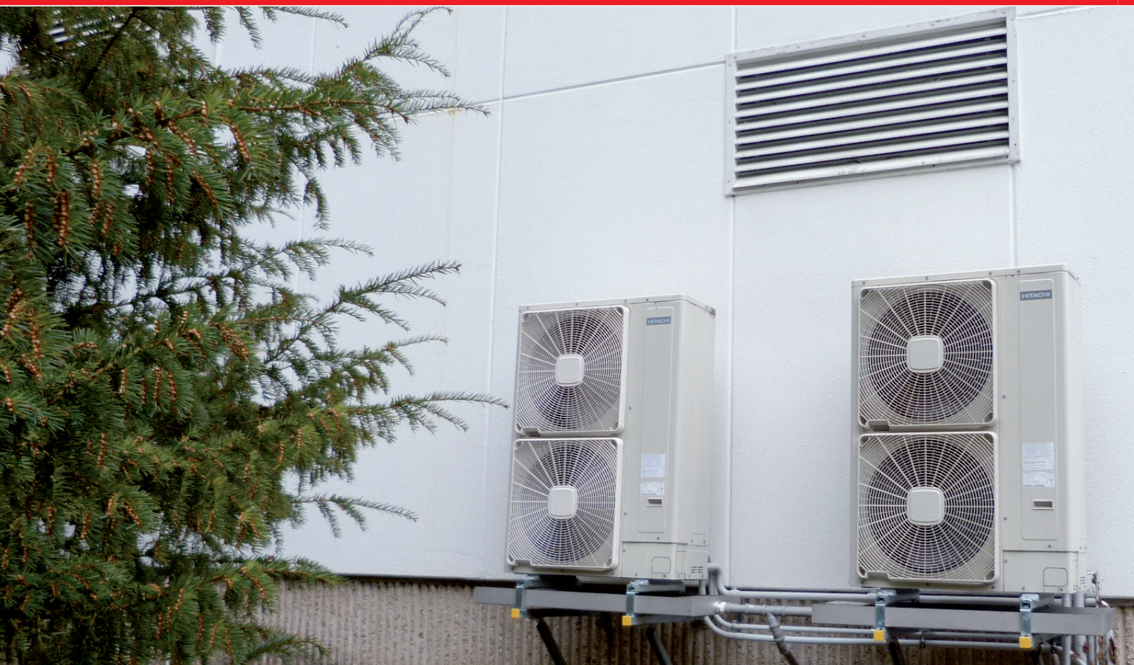
Den Richtlinien in Wasserschutzgebieten entsprechend installierte Außeneinheiten mit Öl-Auffang- und Rückhaltesystem
